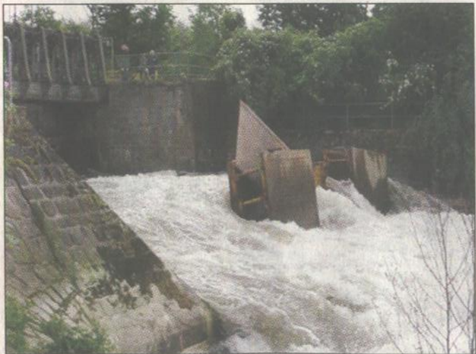
Weggeschwemmt: Das Behelfsstauwerk am Müden Wehr hat nicht lange gehalten. Jetzt werden Rohre eingesetzt.
